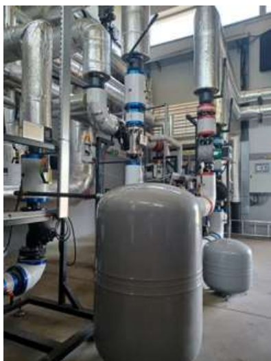
Kotłownia gazowa - infrastruktura
